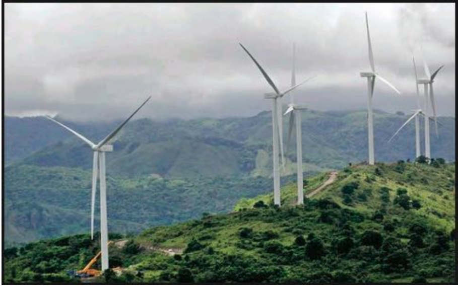
Gambar 10 Pembangkit Listrik Tenaga Angin 175
